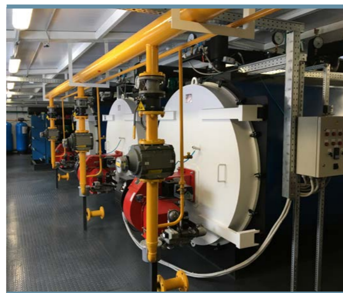
Владимирская область, город Киржач. Оборудование блочно-модульной котельной
