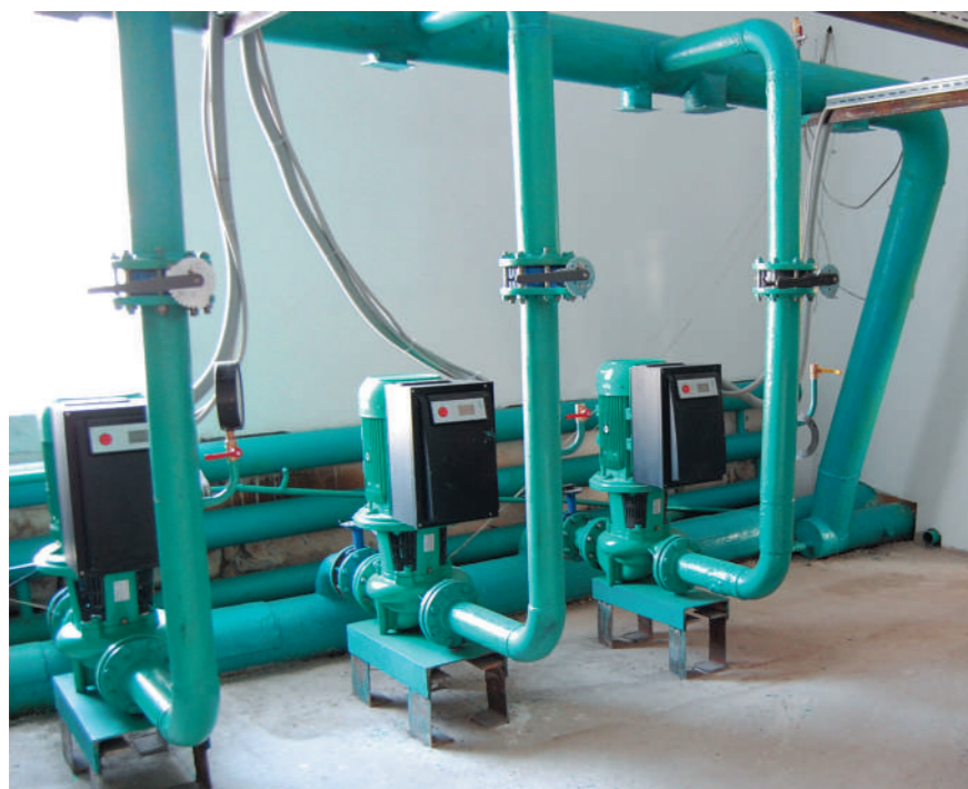
Насосное оборудование после модернизации в муниципальном образовании Ленский наслег Намского улуса Республики Саха (Якутия)
