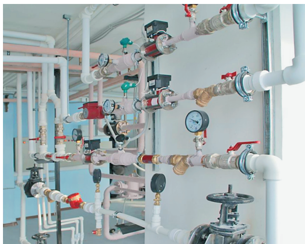
Республика Саха (Якутия). Энергоэффективное оборудование, индивидуальный тепловой пункт
