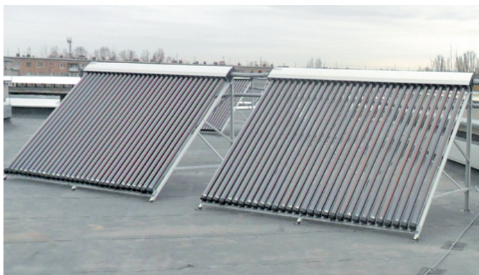
Волгоградская область, город Волжский. Солнечные коллекторы на кровле энергоэффективного дома
