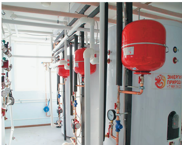
Республика Саха (Якутия), город Жатай. Оборудование в энергоэффективном доме
