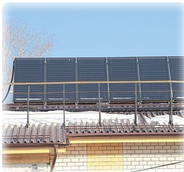
Рисунок 8. Владимирская область, город Собинка. Солнечные коллекторы на крыше энергоэффективного дома
