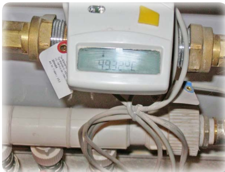
Рисунок 32. Омская область, поселок городского типа Русская поляна. Оборудование в энергоэффективном доме
