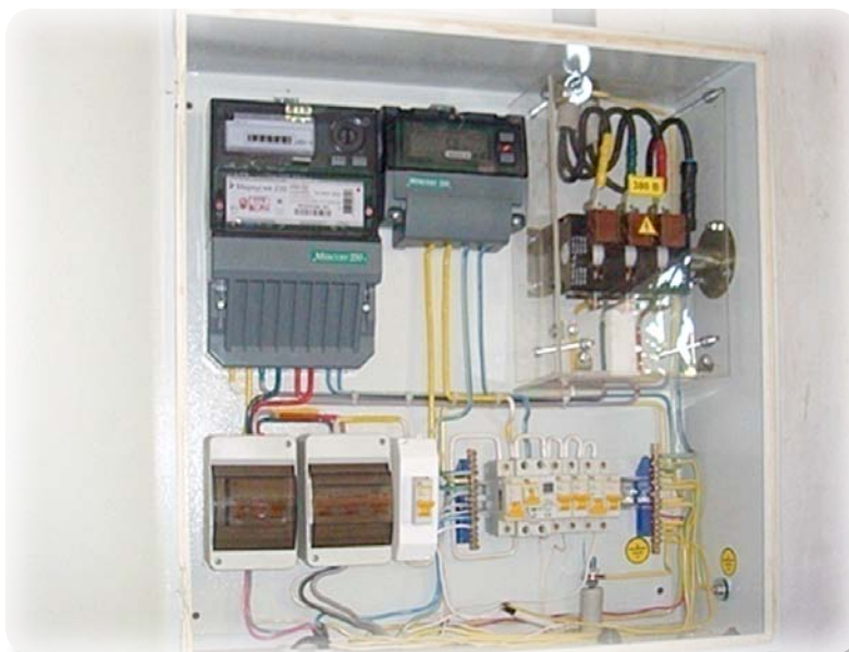
Рисунок 15. Краснодарский край, город Ейск. Оборудование, установленное в многоквартирном доме после проведения капитального ремонта
