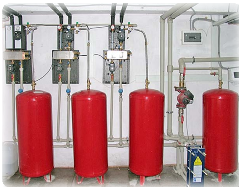
Рисунок 40. Республика Дагестан, город Каспийск. Оборудование в энергоэффективном доме
