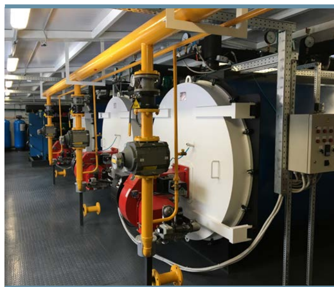
Владимирская область, город Киржач. Оборудование блочно-модульной котельной
