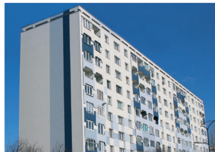
Калининградская область, город Калининград. Утепленный фасад дома в рамках проведения энергоэффективного капитального ремонта
