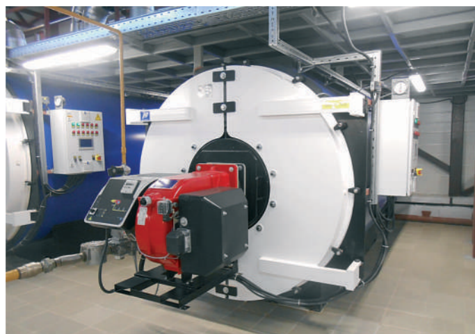
Тульская область, рабочий поселок Чернь. Оборудование блочно-модульной котельной мощностью 11 МВт
