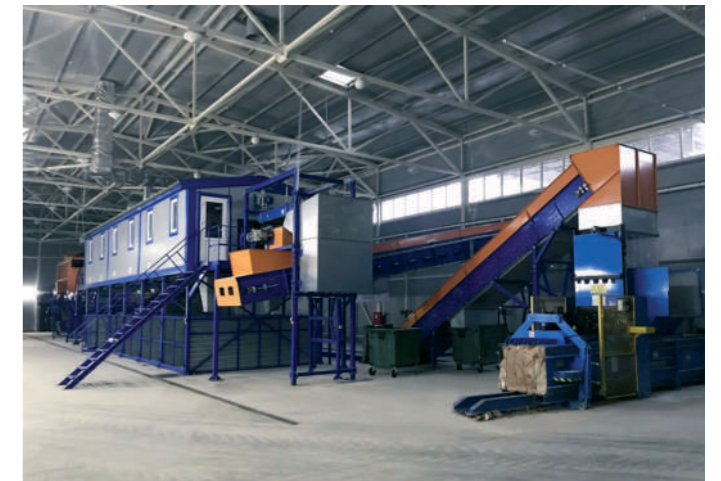
Карачаево-Черкесская Республика, город Черкесск. Полигон ТКО с мусоросортировочной станцией мощностью до 40 тыс. тонн/год
