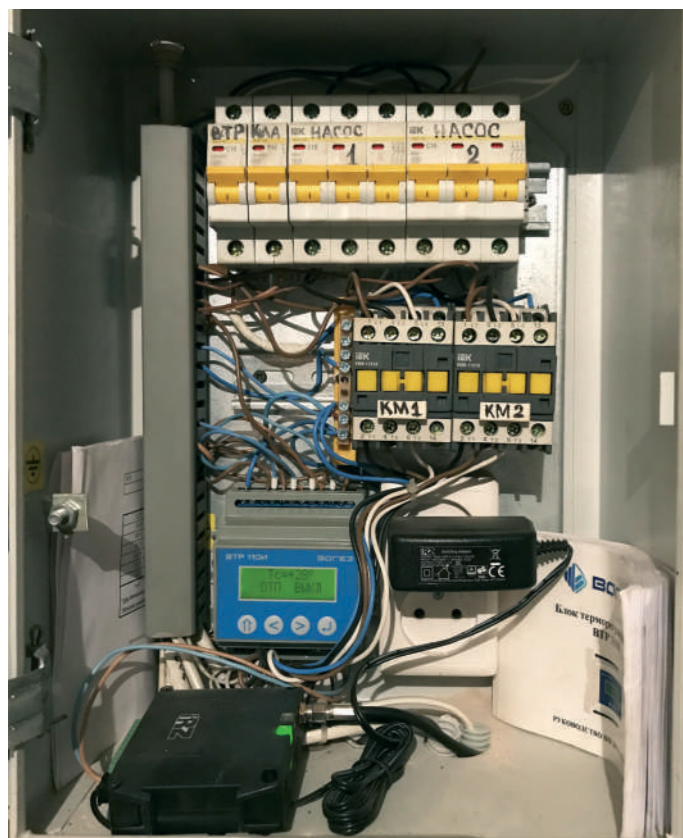
Ульяновская область, город Ульяновск. Модуль управления индивидуальным тепловым пунктом
