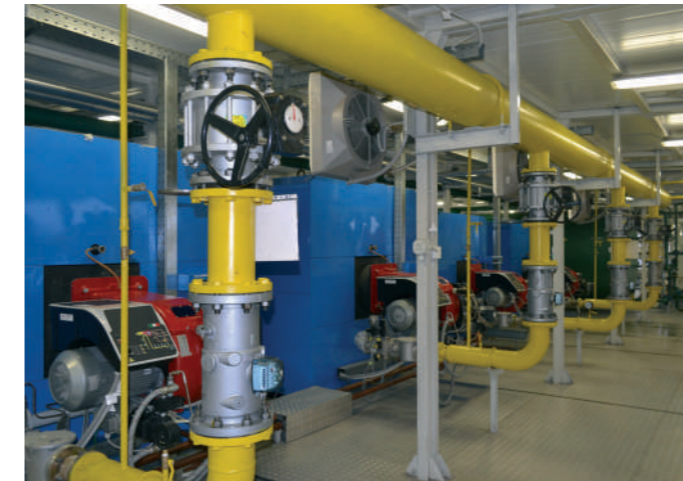
Республика Башкортостан, город Туймазы. Оборудование блочно-модульной котельной мощностью 22 МВт
