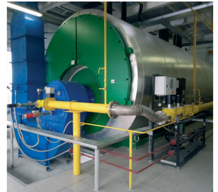
Челябинская область, город Троицк. Оборудование газовой котельной мощностью 120 МВт
