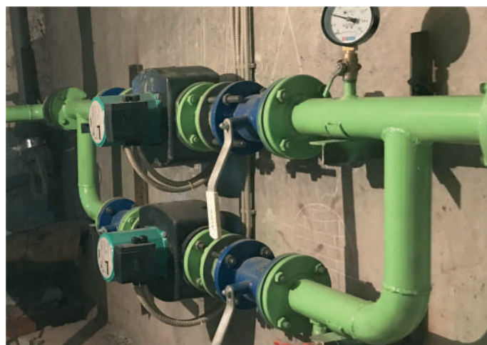
Ульяновская область, город Ульяновск. Узел регулирования подачи тепловой энергии дома
