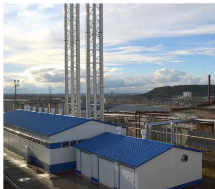
Республика Башкортостан, село Кандры. Блочно-модульная котельная мощностью 33 МВт
